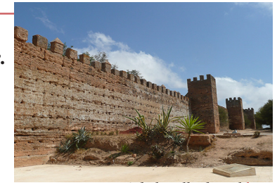
Enceinte en pisé de la ville de Rabat (Maroc). Période almohade (fin XII e s.) © Claire-Anne de Chazelles
